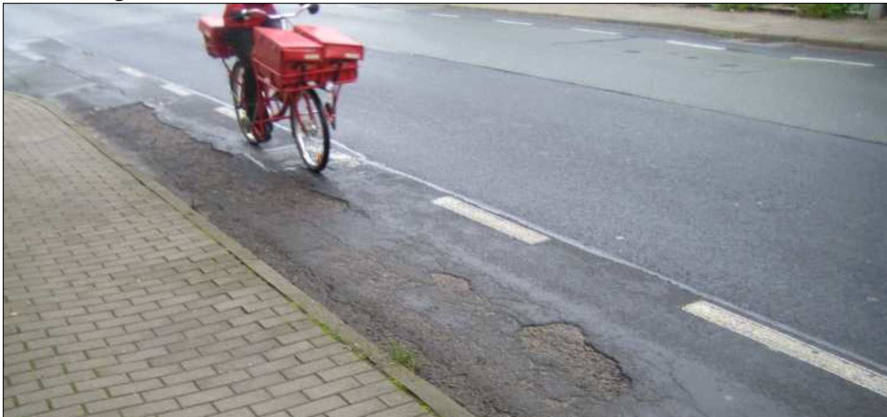
Abb. 1: Beschädigte Deckschicht auf dem Schutzstreifen
