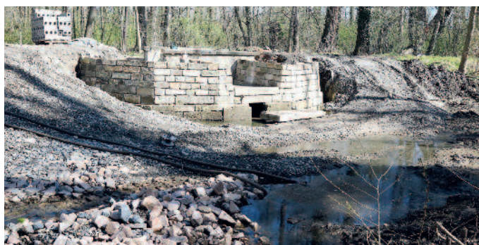
Dem Wal in Jahnishausen fehlt aus baulichen Gründen derzeit das Wasser. Ob die Entschlammung möglich ist, muss sich in den nächsten Wochen klären. Foto: U.P.
