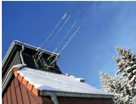
Auch im Winter verteilen die Trafostationen, wie diese in Cnitz, den Strom zuverlässig weiter.
